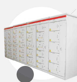
Centro de control de motores CCM
